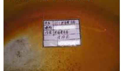
FRP貯水槽中（清掃前）
